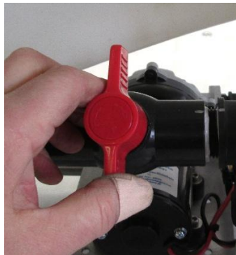
Schließen des Filterkugelhahns
