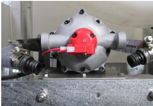
Saug- und Druckstutzen sind demontiert
