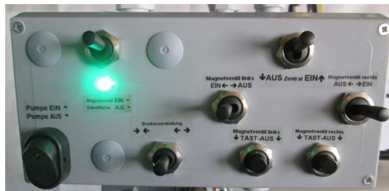
Alle Schalter für die Magnetventile sind in Schaltstellung EIN
